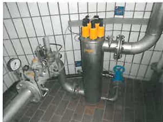
Foto 2 - UV-Anlage Hochbehälter Eulenstein (Foto: Martin Baldes, 2014:09.11 11:43:23)
