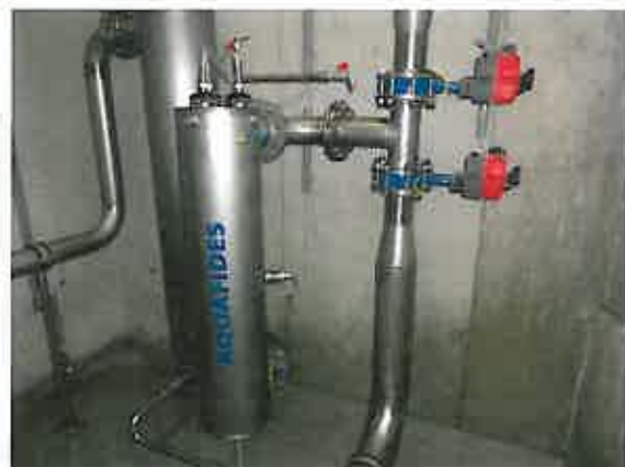
Foto 2 - UV-Anlage Hochbehälter Schönau (Foto: Martin Baldes, 2014.09.11 12:52:48)
