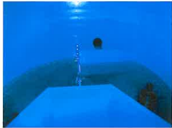
Foto 4 - Innenansicht der Quellstube (Oberen Thalerquelle) (Foto: Martin Baldes, 2014 09:11 12 37 59)
