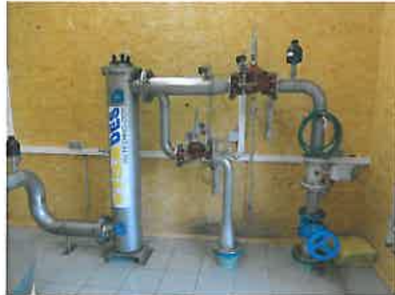
Foto 2 - UV-Anlage Tiefbrunnen Schusterwinkel (Foto: Martin Baldes, 2014:09:11 09:39:23)
